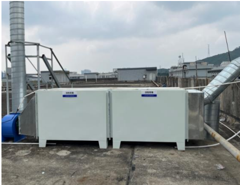
楼顶 2 级活性炭设施
