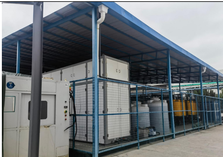
废水回用处理设施
