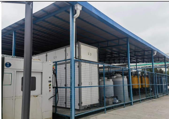
废水回用处理设施
