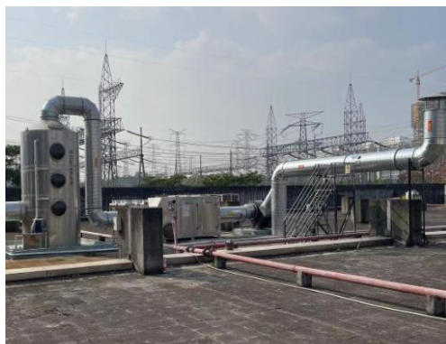
酒精废气处理设施
