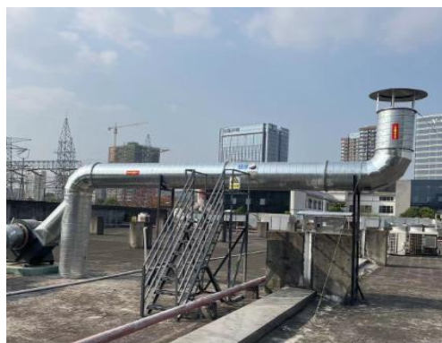
酒精废气排放口及检测平台
