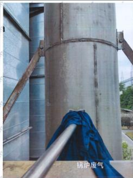
锅炉废气检测口
