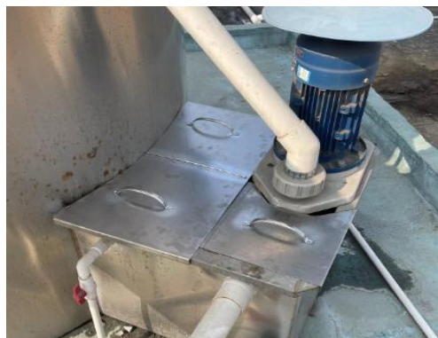
喷淋塔防雨盖板及围堰
