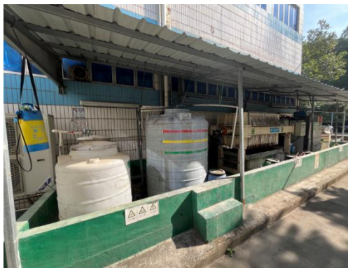
原有废水回用处理设施
