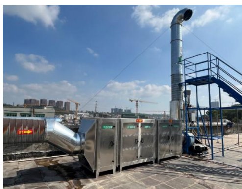
2号楼废气处理设施
