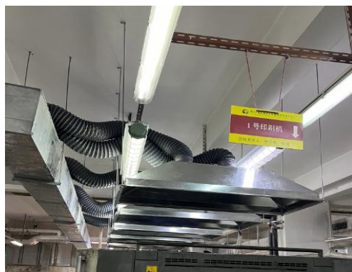
收集罩及收集管道
