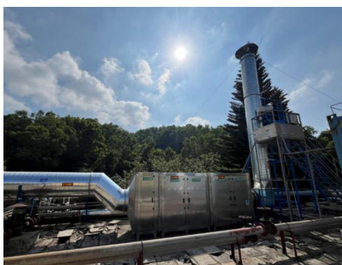
1号楼废气处理设施
