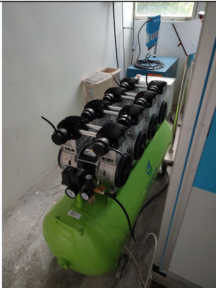
项目空压机房
