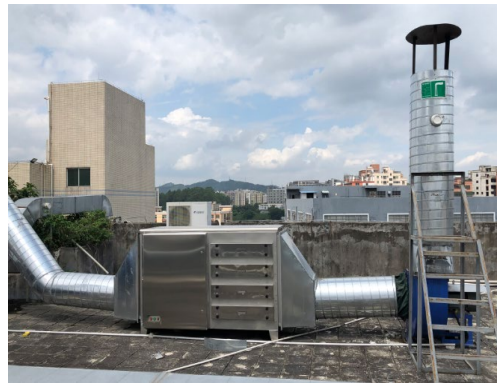
废气处理措施
